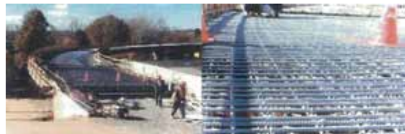
道路床版 (融雪塩による塩害対策)
